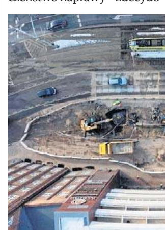
Na zdjęciu widać miejsce awarii, gdzie wymieniono kawałek wodociągu. Poniżej Kings Apartments
