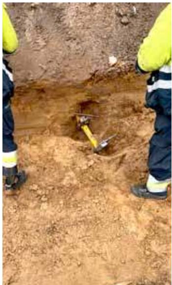
6 lutego strażacy zostali zadysponowani do zabezpieczenia uszkodzonej rury z gazem w miejscowości Motaniec. Foto. OSP. Kobylanka
