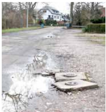
Narazie możliwe są jedynie bieżące prace naprawcze, które oby jak najszybciej nastąpiły, bo jest niebezpieczne
