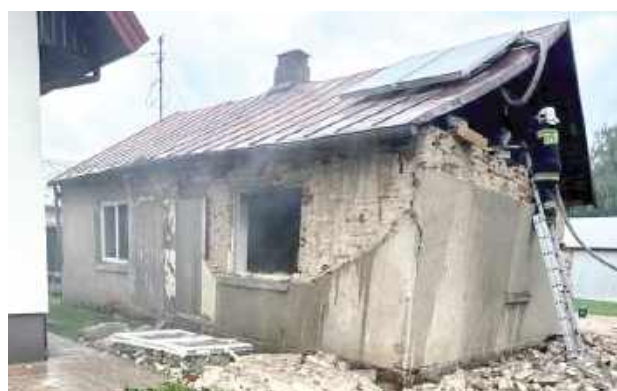
Siła wybuchu była tak ogromna, że budynek został poważnie uszkodzony, a rodzina otrzymała nakaz jego rozbioru
