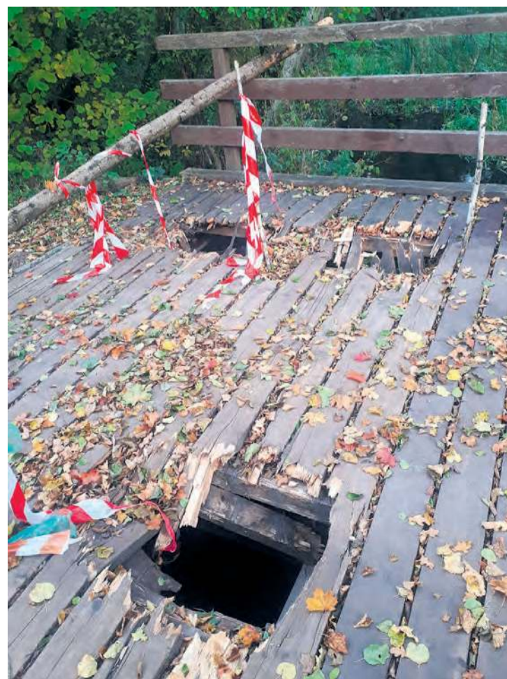
Tak poważne uszkodzenia zostały zauważone na moście w Świcie już jesienią zeszłego roku. Fot. G.
