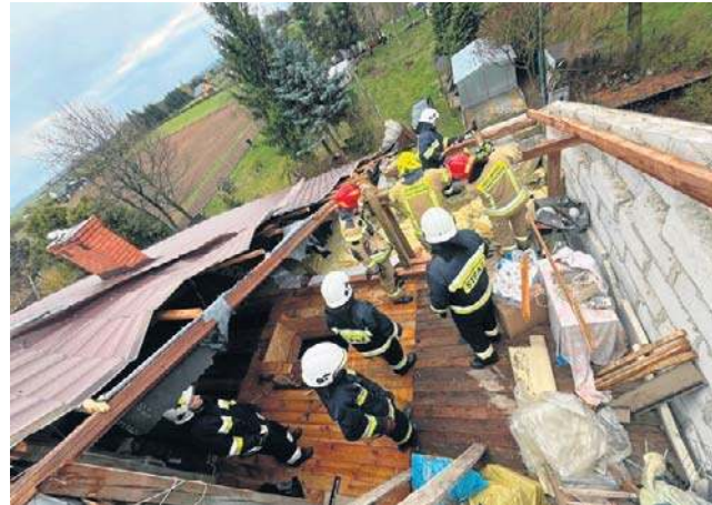
Płoskie pod Zamościem. Tu silny wiatr zerwał dach z budynku mieszkalnego
