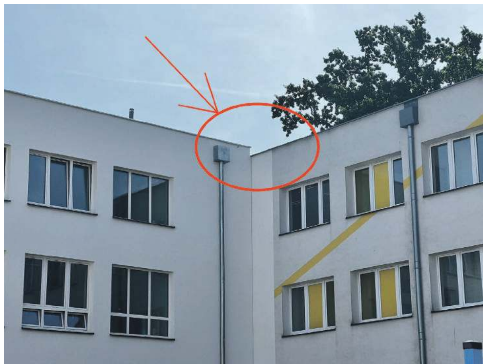
Inspektor wskazał, że poziomy korytarz nie są spasowane i powstały pochylnię. Na zdjęciu widać, że nowe skrzydło jest wyższe od starej części szkoły
