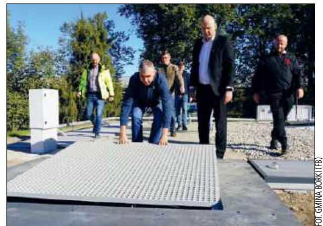
– Zmodernizowana oczyszczalnia zapewni bezpieczeństwo mieszkańcom i środowisku, a także pozwoli obniżyć koszty eksploatacji obiektu – zapewnia wójt Marcin Czyżak
