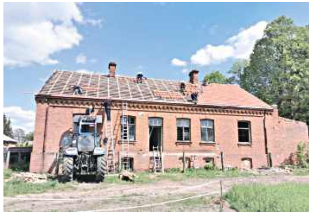
Budynek plebanii kilka lat temu zabezpieczono i czekał na remont, który niebawem się odbędzie
