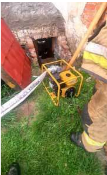
W miejscowości Płoszkowo strażacy wypompowywali wodę z zalanej piwnicy. Foto. OSP. Dolice
