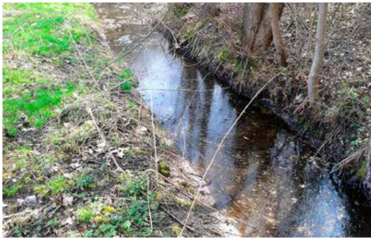
Zdaniem rolnika, ten rów nie odprowadza wody.
