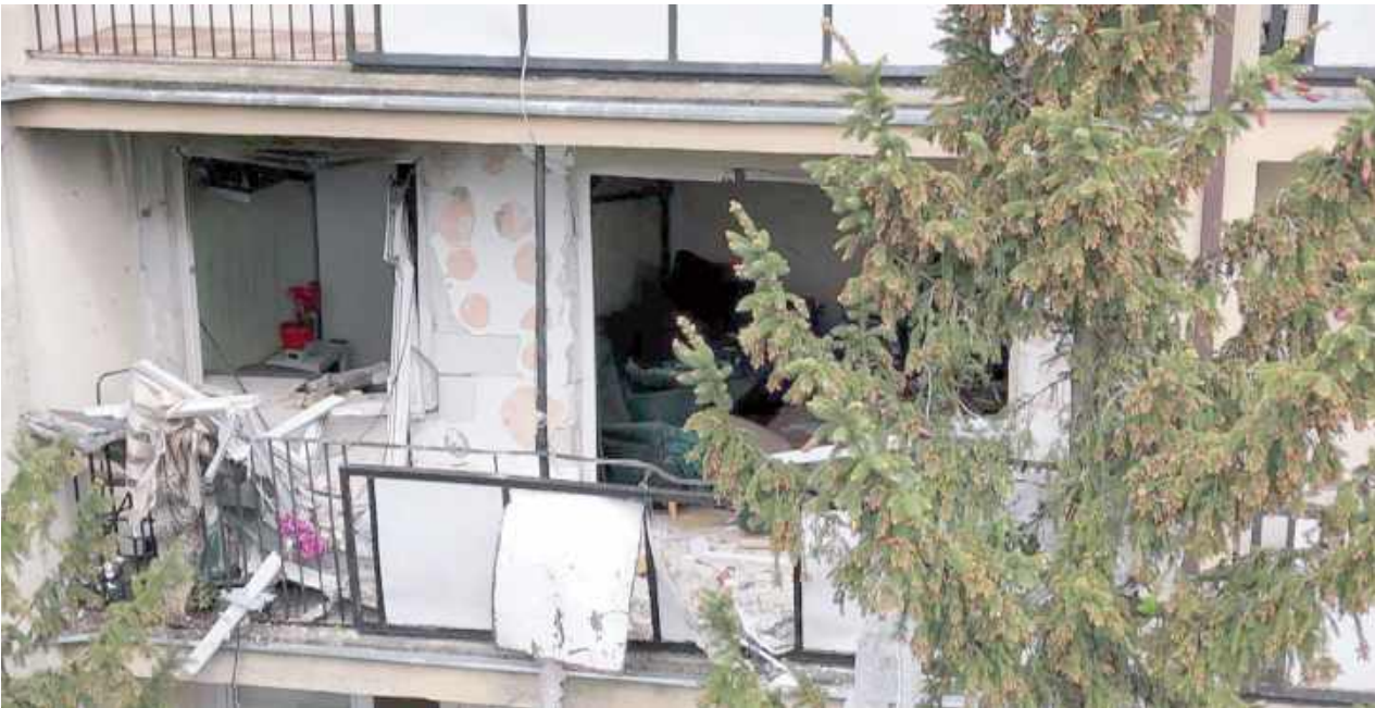
Wybuch gazu poważnie zniszczył mieszkanie na pierwszym piętrze
