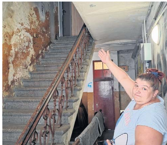
Pani Karolina mieszka w kamienicy od 10 lat i w tym czasie nie widziała remontu. A stan klatki schodowej – jak pokazuje – jest tragiczny
