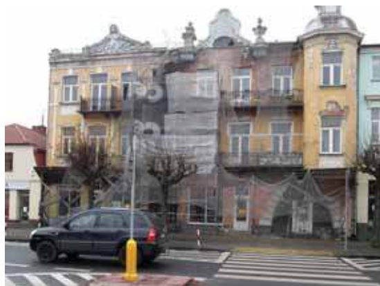
Obiekt wymaga szybkiego remontu
