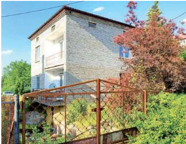
Pożar wybuchł w jednym z pomieszczeń na parterze. Na zewnątrz do dziś leżą nadpalone meble
