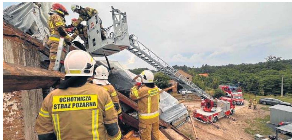
W Nowej Wsi Zbąskiej wiatr zerwał część pokrycia dachowego z budynku wielorodzinnego
