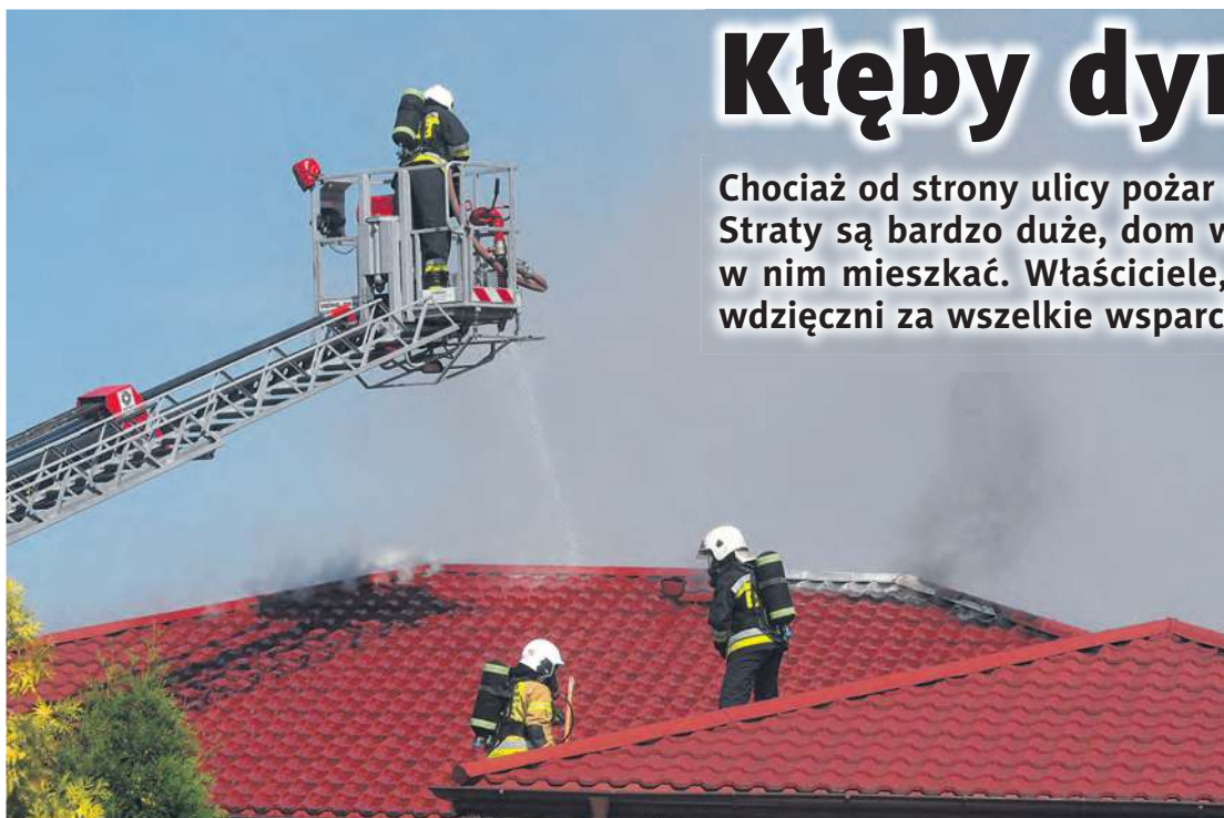
Ogień dostał się pod pokrycie dachowe i tam zaczął siać zniszczenie. Fot. Piotr Paterski
