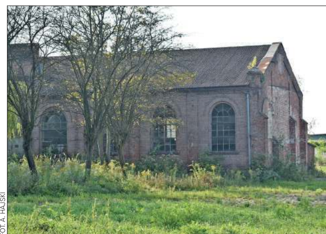
W obecnym stanie budynek łaźni wymaga wielu modernizacji
