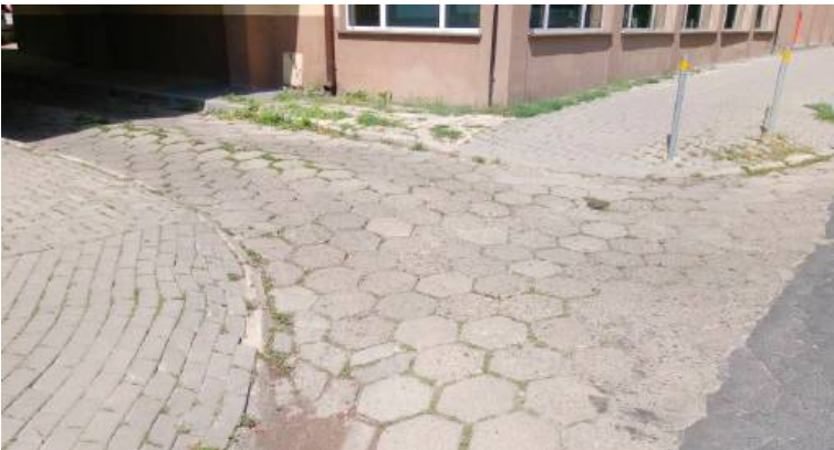
Zniszczony chodnik przy ul. Łopacińskiego ma być naprawiony jeszcze w tym miesiącu
