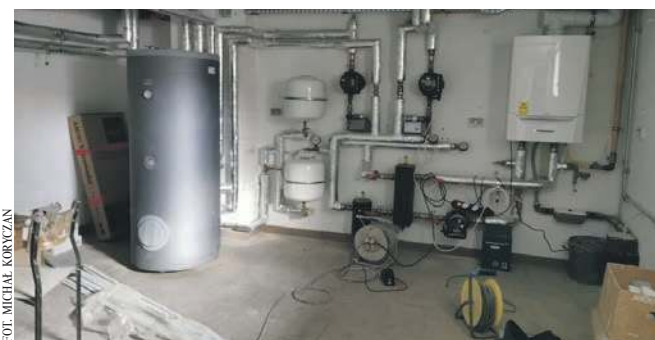
Zmodernizowana kotłownia w remizie
