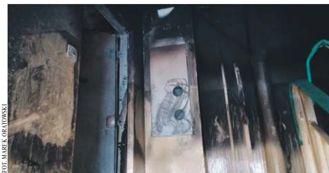
Klatka na trzecim piętrze była cała osmolona
