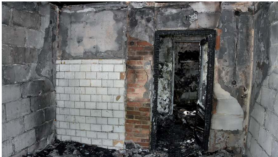
Skutki podpalenia niezamieszkałego domu
