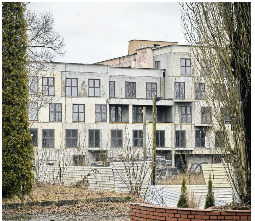
• Opuszczona i niedokończona inwestycja Tuwima Gardens FOT. MARCIN STEPIEŃ / AGENCJA WYBORCZA.PL
