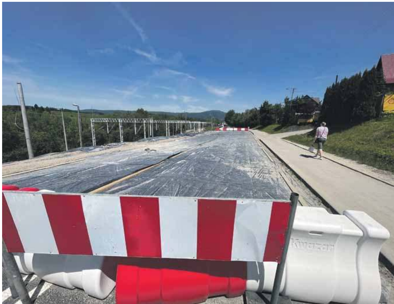
Od wielu miesięcy Rabka jest pozbawiona głównego wjazdu.
