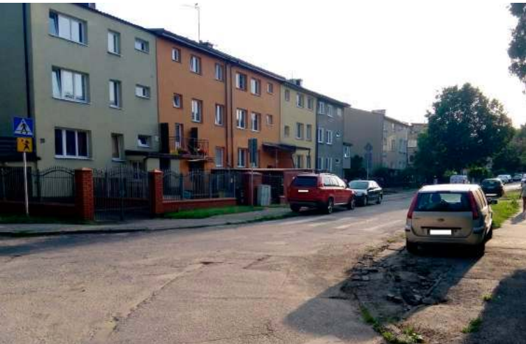
Ledwie widoczna „zebra”, brak oznakowania, zrujnowany chodnik. Mieszkańcy Cedrowej domagają się zmian
