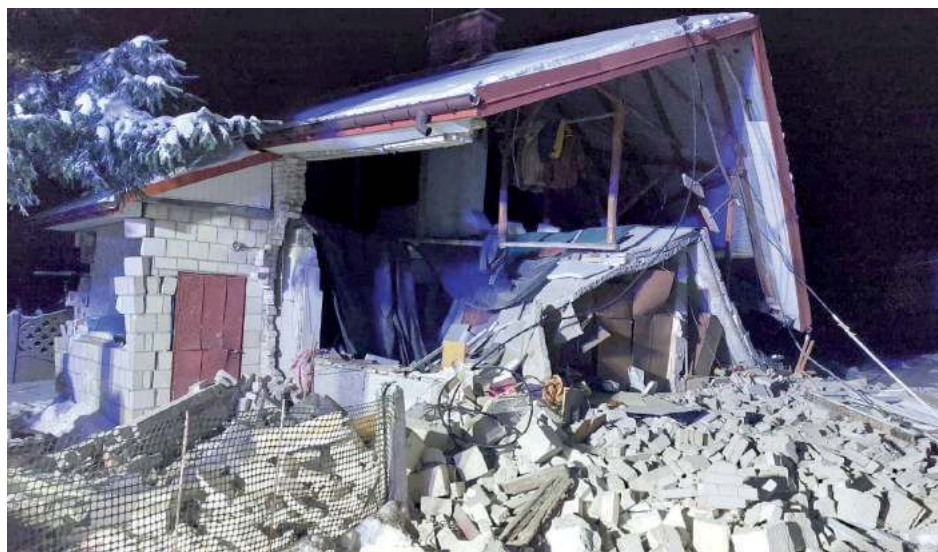
Doszło do częściowego zawalenia się ścian zewnętrznych, wewnętrznych oraz stropu budynku mieszkalnego
