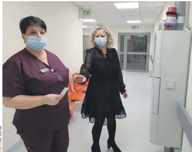
Jedna z siedmiu stacji poczty pneumatycznej w szpitalu na oddziale ginekologii i położnictwa. Na zdj. Renata Tokarska zastępca oddziałowej oraz Urszula Bogdan zastępca dyrektora ds. infrastruktury i logistyki w szpitalu
