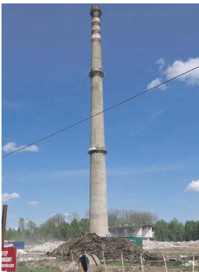
122-metrowy komin dawnej ciepłowni w Trzebini został wysadzony 7 maja. Prace porządkowe i wyburzeniowe trwają od lutego
