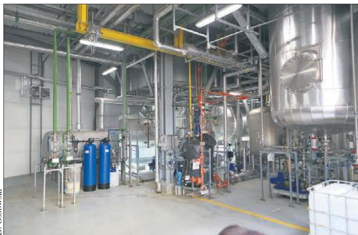
Instalacje UCO FAME to kolejny krok w transformacji ORLEN-u Południe w biorafinerię
