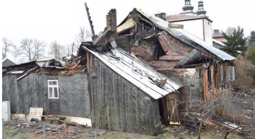
Spalił się dach, zawalił strop, wypaliło wyposażenie
