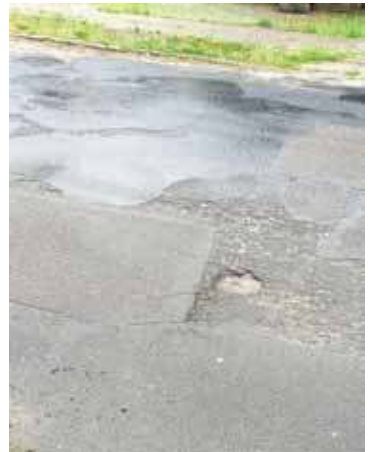
Jezdnia ulicy Sikorskiego jest w fatalnym stanie, bez trudu można dostrzec ubytki
