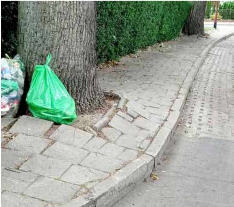
Chodnik przy Alei Dębowej jest w fatalnym stanie, płyty są nierówne niemal na całej długości
