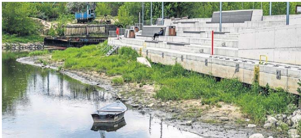
Normalnie wiślana woda dochodzi co najmniej do betonowego nabrzeża w Fordonie. W piątek, 8 maja sytuacja wyglądała jak na zdjęciu.
