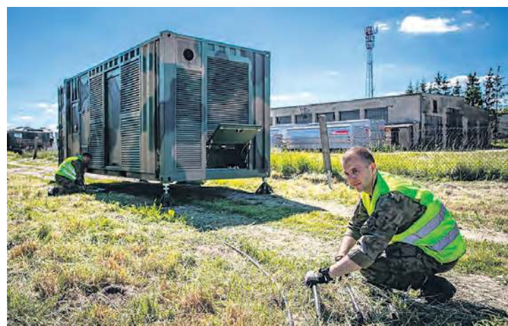
Maksymalna moc kontenerowej elektrowni polowej wynosi 900 kW.
