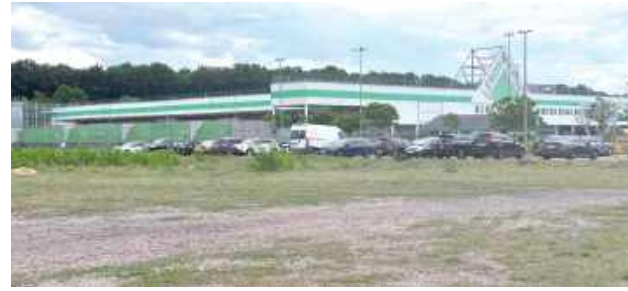
W Puławach przybędzie kolejna galeria. Właśnie rozpoczęła się jej budowa, która zostanie ulokowana na ul. Dęblińskiej w bliskiej odległości „Leroy Merlin” i „Karuze-la”. Zakupy zrobimy w pierwszej połowie 2027 roku
