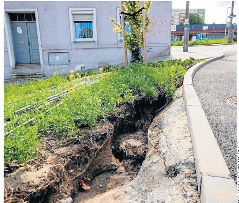
Zniszczony został również teren zielony przy jezdni
