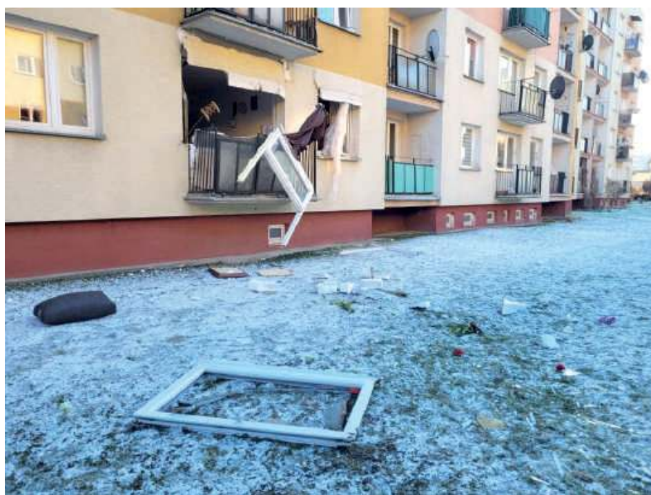
Siła wybuchu była tak duża, że okna i ściany zostały mocno uszkodzone
