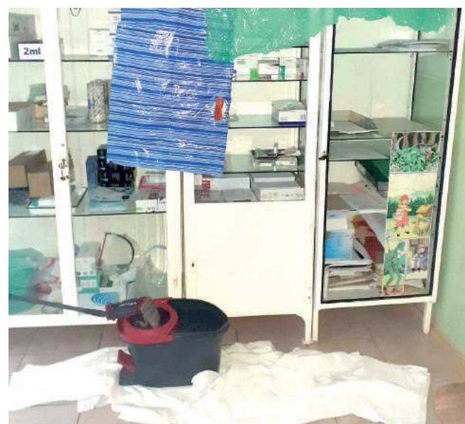
– Woda lała się strumieniem, a przeciek jest w miejscu, gdzie przebiega instalacja elektryczna – alarmowali właściciele praktyki
