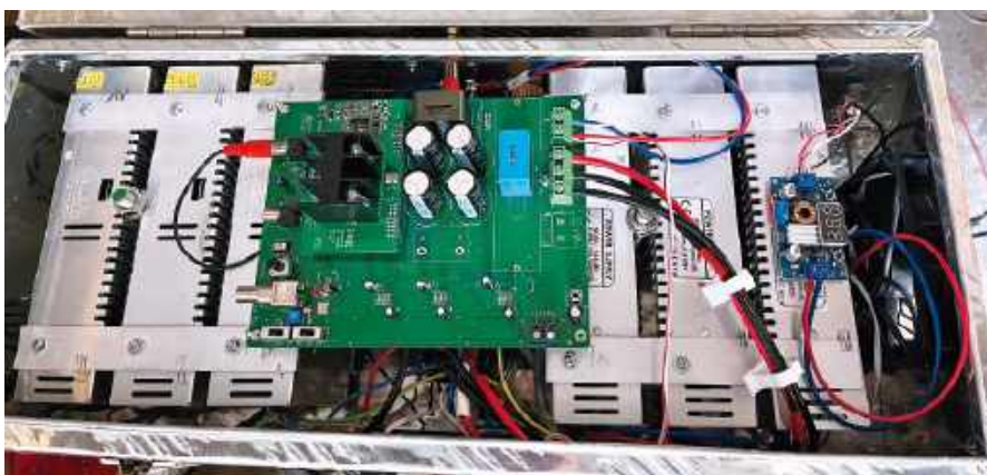
Fotografia 9. Zasilacze impulsowe ładnie mieszczą się w aluminiowej skrzynce narzędziowej, a kilowatowy wzmacniacz zamontowany na plastikowych izolatorach zajmuje niewielką powierzchnię w górnej części. Mały moduł po prawej stronie zapewnia napięcie 12 V z wyjścia 24 V...25 V dowolnego zasilacza impulsowego, do zasilania wentylatora 12 V DC i podświetlenia wskaźnika wysterowania
