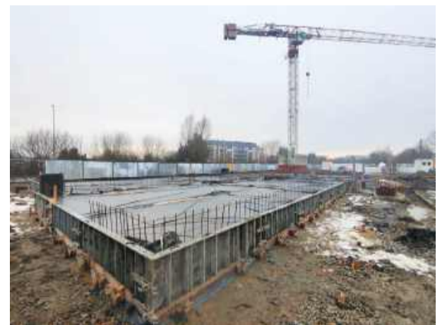
Tak obecnie wygląda plac budowy. Pod koniec ubiegłego tygodnia wylano fundamenty. Fot. DTBS
