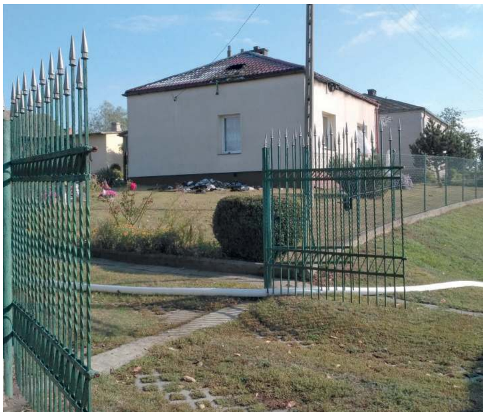
Prawdopodobnie przyczyną pożaru była nieszczelność przewodów kominowych. Strych, więźba dachowa, materiały zgromadzone na strychu, w tym dużo łatwopalnych - wszystko uległo spaleni. Straty oszacowano na 100 tys. zł
