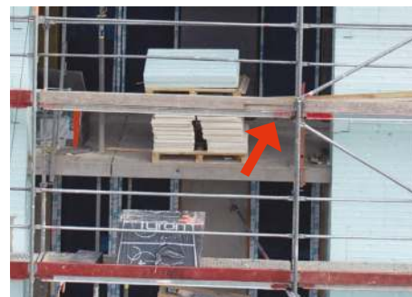
Rys. 5. Widok na uszkodzoną deskę krawężnikową
