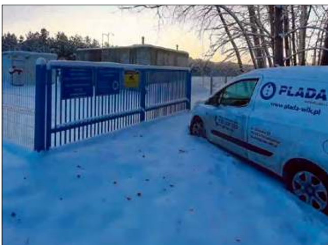
Stacja uzdatniania wody w Chrzastowicach.
