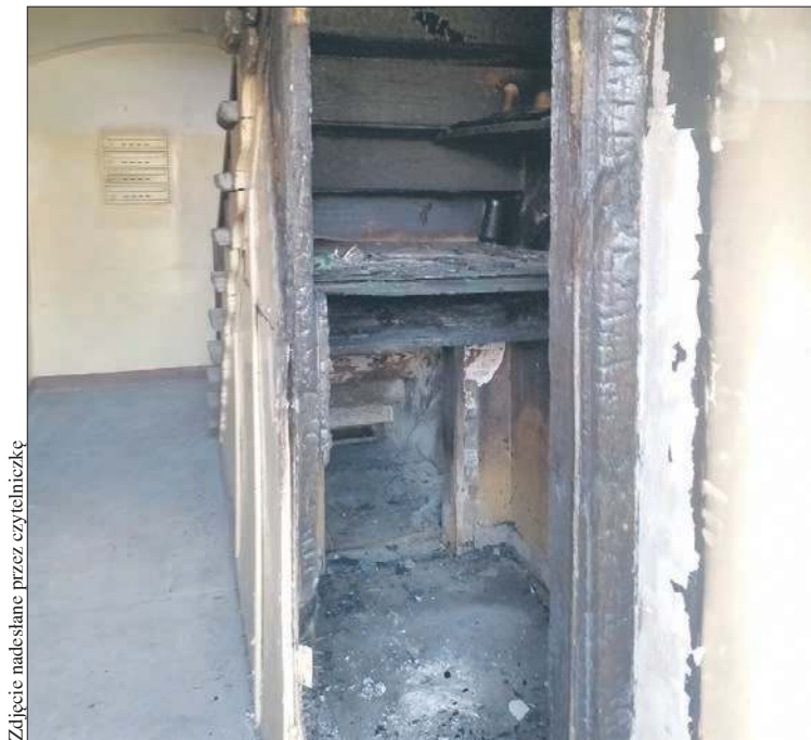
Tak po pożarze wygląda klatka schodowa w budynku przy ul. Wyszogrodzkiej 34/1
