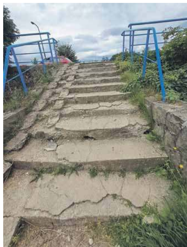
I kto ma wyremontować te schody?
