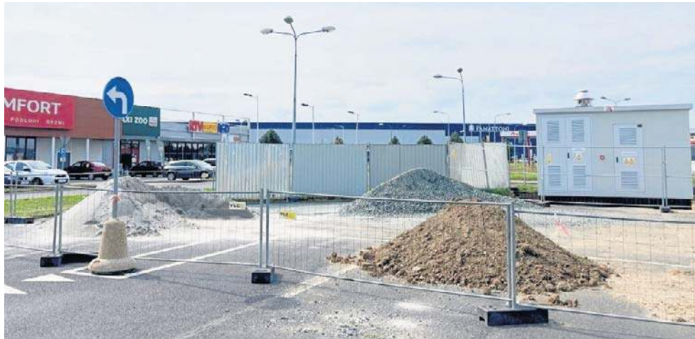
Budowa stacji w Legnicy jest częścią szerszego planu rozwoju sieci Tesli w Polsce i Europie.
