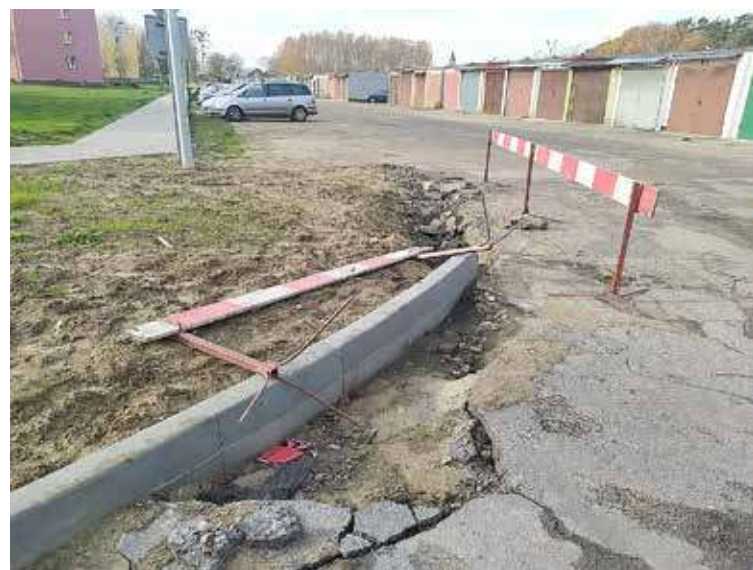
Droga prowadząca do garaży obecnie nie spełnia żadnych norm
