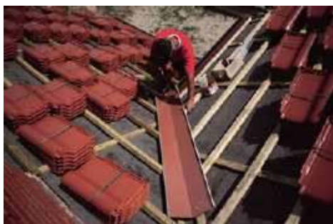
📍 Kosz, czyli miejsce zbiegu dwóch połaci dachu tworzy swoisty lej zbierający i spiętrzający wodę. RÖBEN
