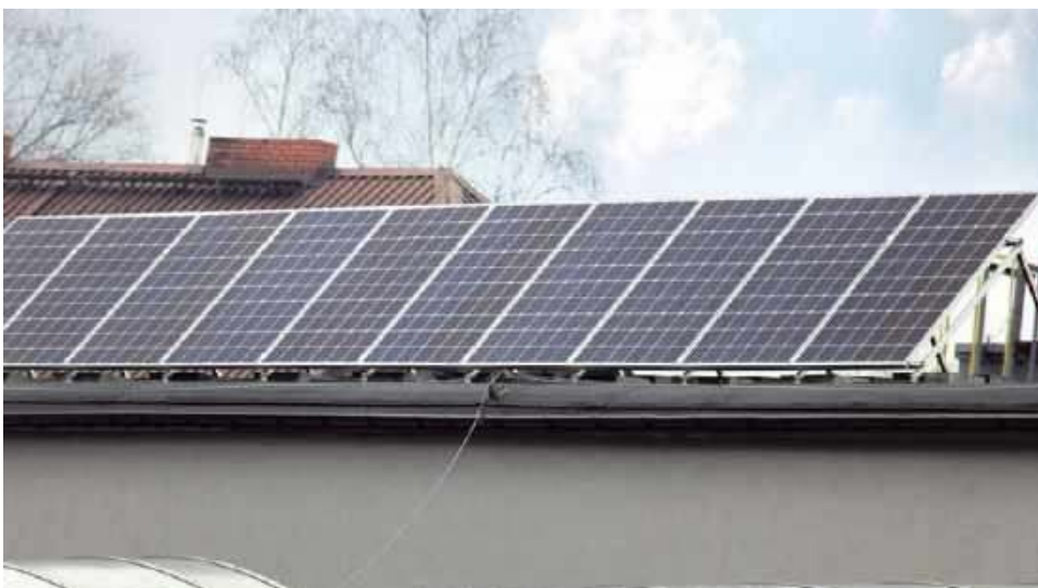
📍 Płaski dach może być bardzo dobrym miejscem do ustawienia paneli. Wówczas opieramy je na niezależnej konstrukcji, wybierając najlepszą orientację względem stron świata i ustalając dowolnie kąt nachylenia. HEWALEX
