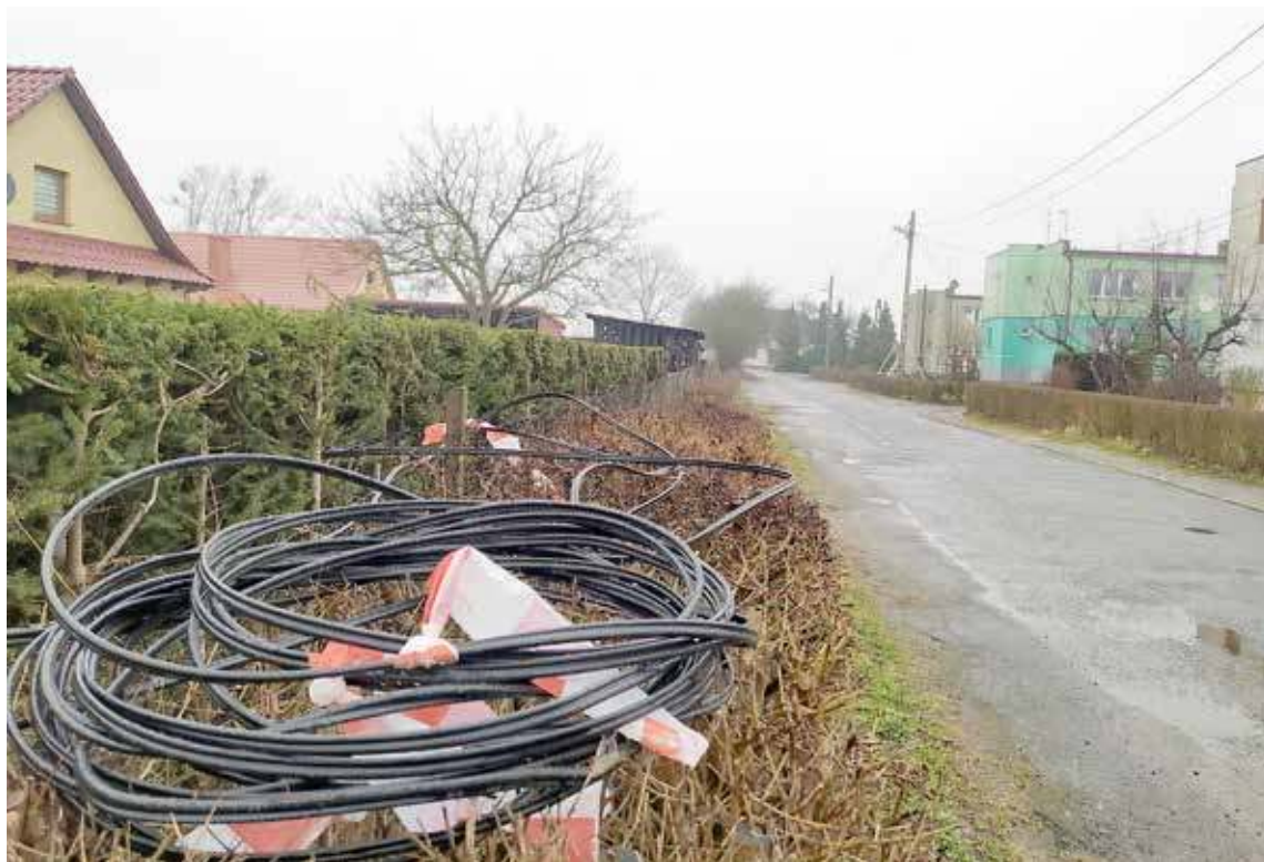
Uszkodzony kabel do transmisji danych leży zwinięty tak od tygodnia
