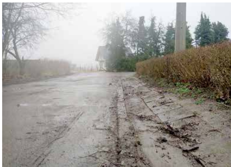
W kilku miejscach drogi wewnętrznej nawierzchnia się dosłownie zapada
