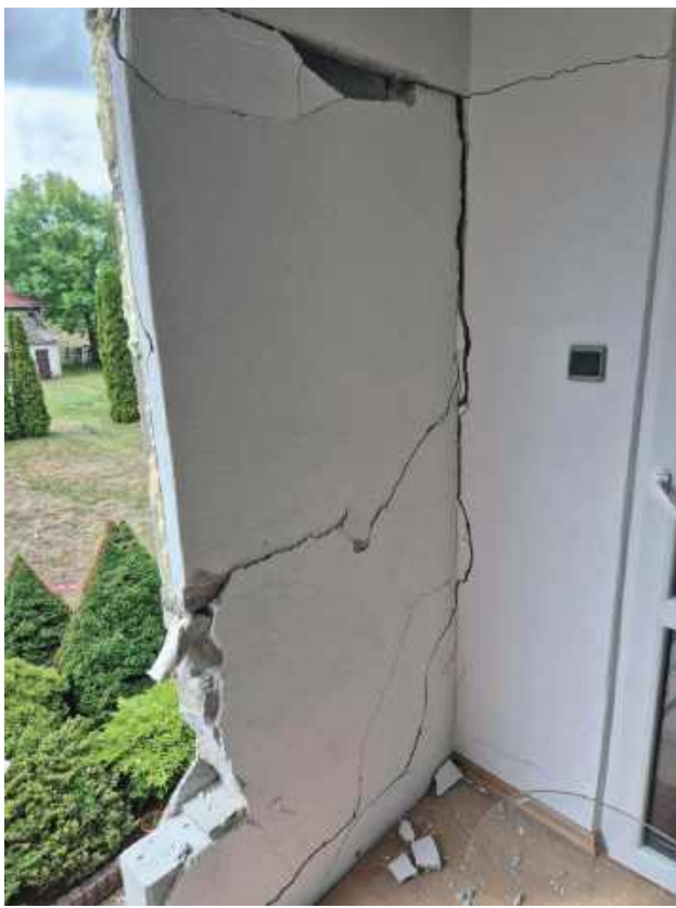
Ze względu na zakres uszkodzeń budynku o zdarzeniu został powiadomiony Powiatowy Inspektorat Nadzoru Budowlanego
