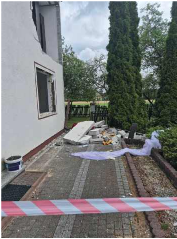
Potężna siła eksplozji doprowadziła do wyrwania okien ze ścian
