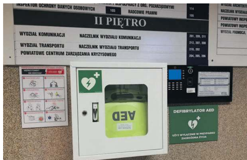
Urządzenie znajduje się na parterze budynku Starostwa Powiatowego w Stalowej Woli
