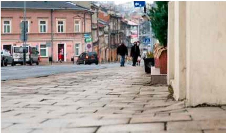
Chodniki przy Lubartowskiej w końcu nie będą straszyć przechodniów
