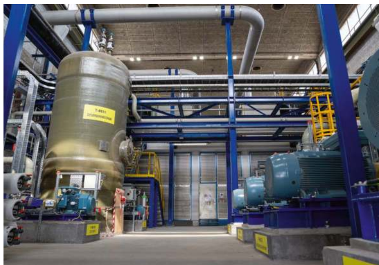
Wnętrze instalacji do produkcji odnawialnego wodoru: zbiornik czystej wody i pompy obiegowe
